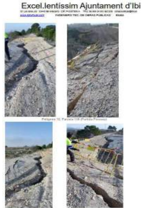
Imagen 55. Ejemplo de fichas de valoración de daños y reportaje fotográfico del evento "Gloria" (enero de 2020). Fuente: Ayuntamiento de Ibi
