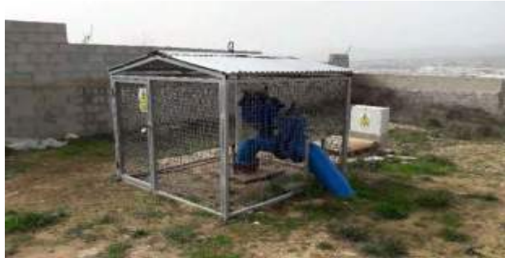
Imagen 10 Pozo N°8, para suministro de agua potable de Ibi. Fuente: Proaguas.
